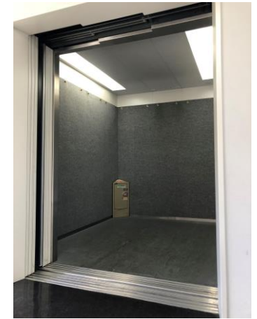
貨物用エレベーター
