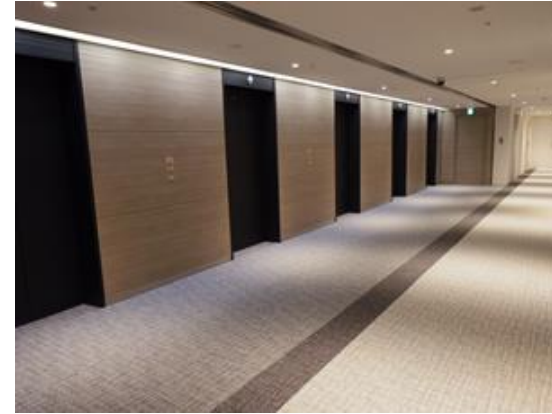
常用エレベーター
