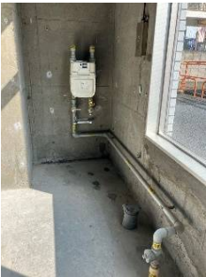
給排水・ガス設備
